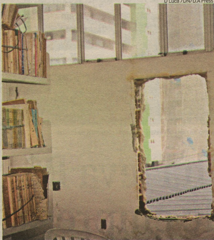
Buraco na parede é apenas um dos vários problemas do espaço público
